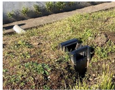
田んぼダムの排水柵
