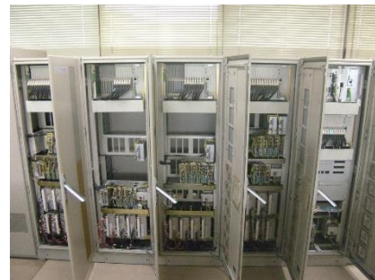
水管理制御設備の更新
