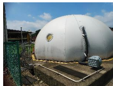
牛ふん尿から生産した バイオガス
