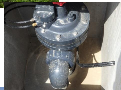
圃場整備により設置した自動給水栓
