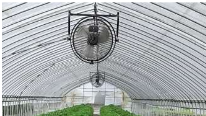
(循環扇を2台設置)
