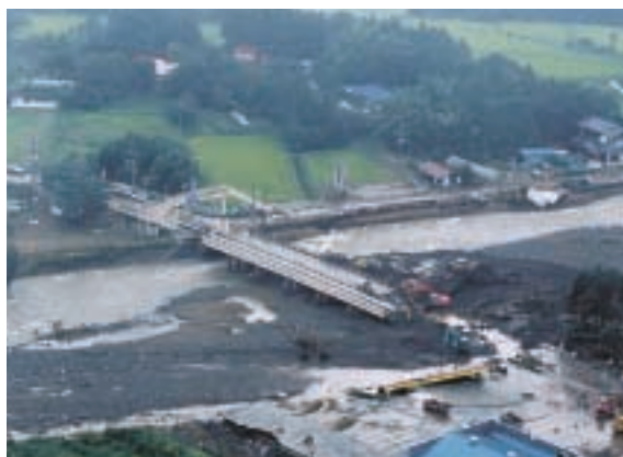
平成10年8月の豪雨により落橋した余笹橋（国道4号）
