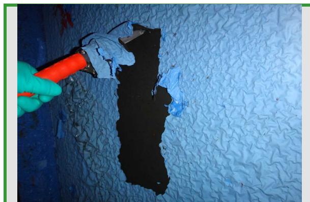
塗膜はく離状況
