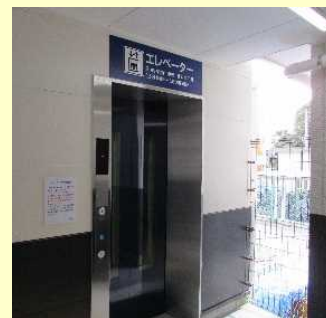
【エレベータ設置】 誰もが安全に駅を 移動できる環境整備
