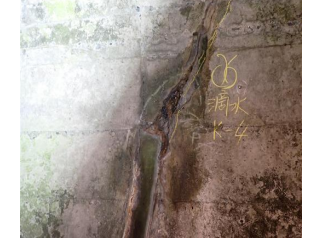
葛老トンネル(日光市) 覆工 うき・はく離(Ⅲ判定)
