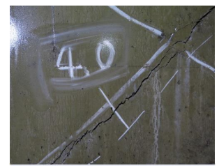
明神ヶ岳トンネル(日光市) 覆工 ひび割れ(Ⅲ判定)
