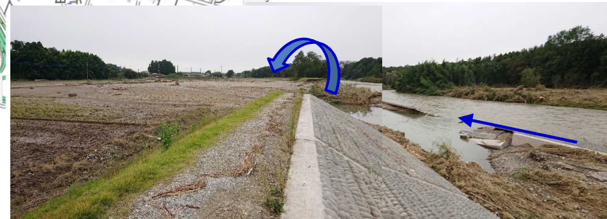
堤防の決壊状況
