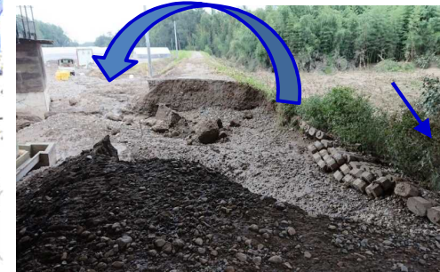
護岸の被災状況
