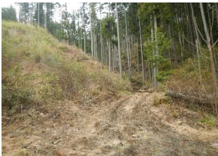
整備前の峠部交通不能区間
