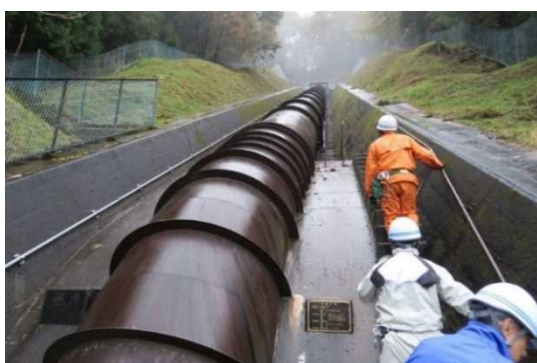
足尾発電所水圧鉄管
