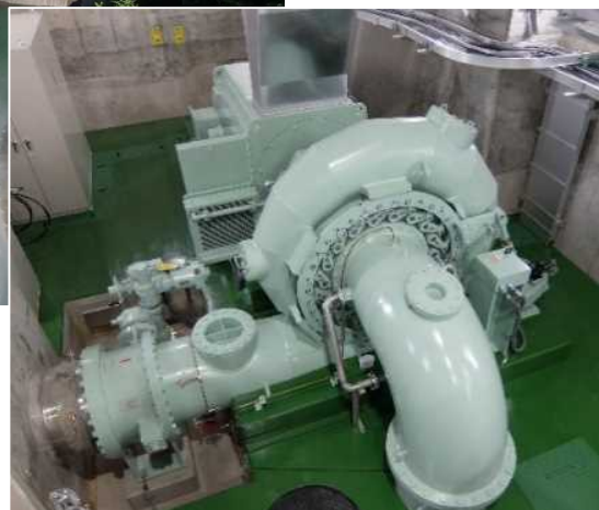
水車・発電機
