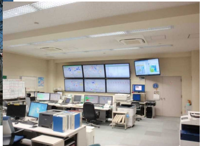
今市発電管理事務所の監視制御室
