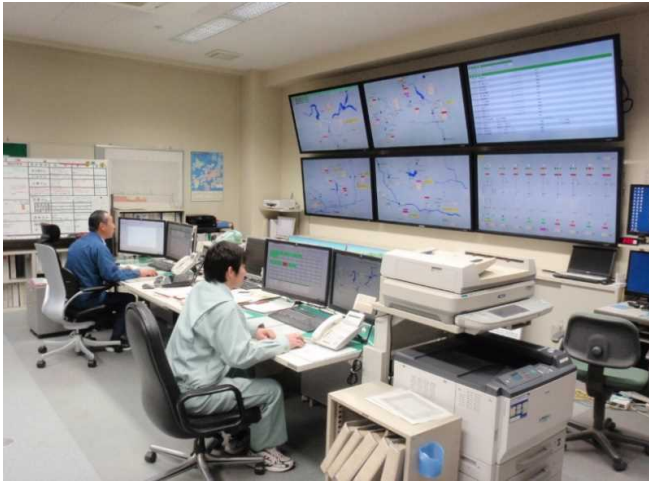
今市発電管理事務所の監視制御室
