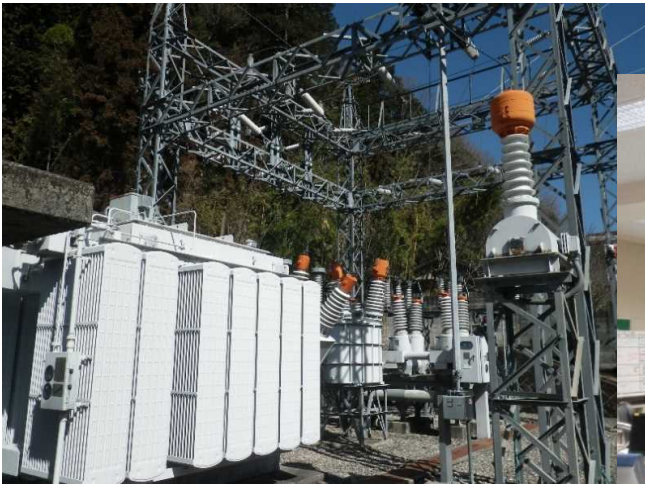
足尾発電所の屋外変電所
