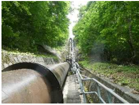
木の俣発電所の水圧鉄管
