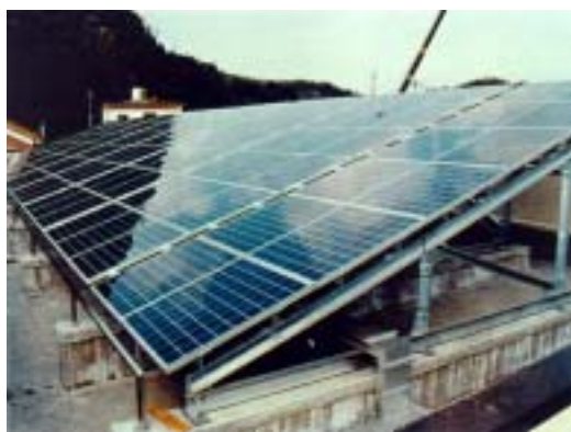
大規模太陽光発電システム
