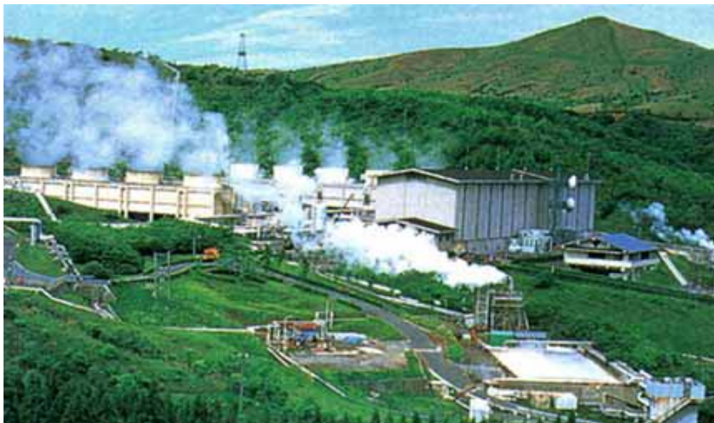
八丁原地熱発電所 11 万 kW の発電容量を持つ大型発電所 (九州電力)
