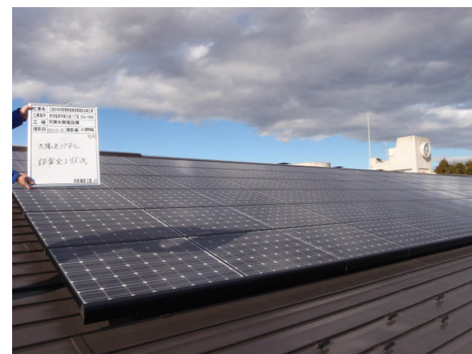
太陽光発電設備
