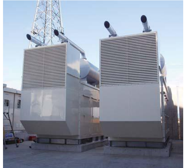
非常用発電機（7日間の電力供給）
