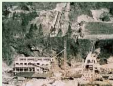
川治第一発電所(建設当時)
