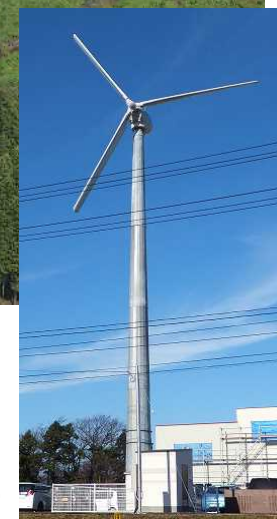
那須マテリアル株式会社 風力発電施設 (秋田県)
