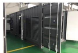
【バイオマス発電ユニット】
