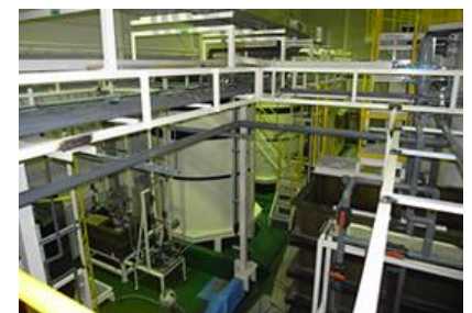
栃木工場 排水処理設備
