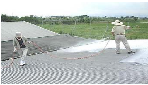
屋根への断熱資材（石灰）塗布作業 ⇒ 屋根裏温度 5℃以上の低下
