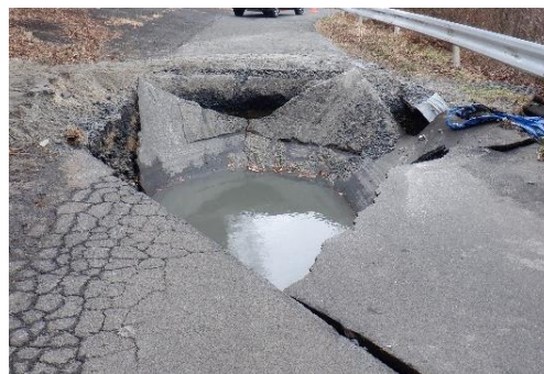
写真1-1 管水路の漏水事故
