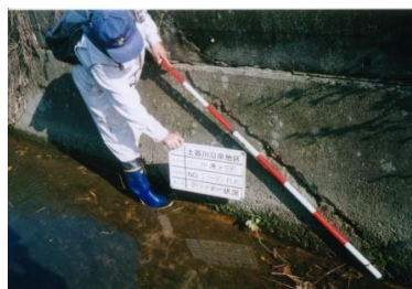
写真 4-2 2次診断 目視によるひび割れの確認
