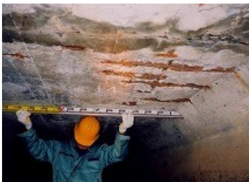
写真1 鉄筋が露出している状況
