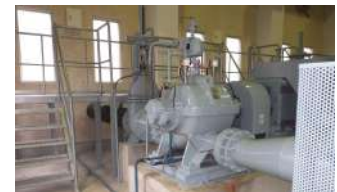
塩田揚水機場ポンプ
