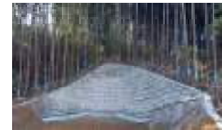
復旧中の漏水事故現場
