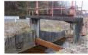
老朽化した取水堰
