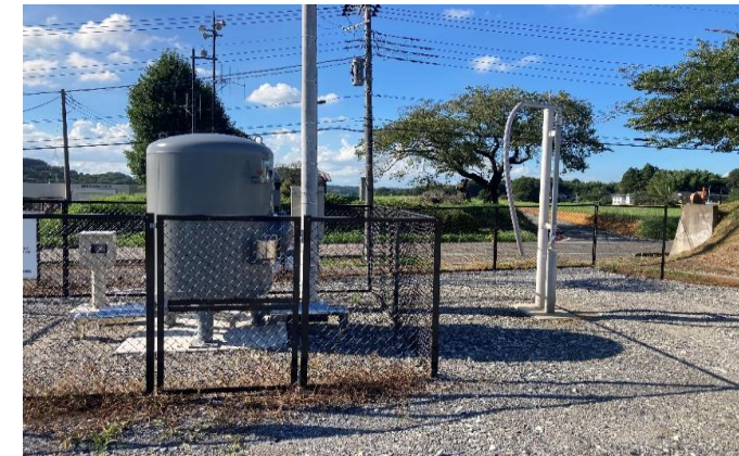
畑地かんがい用に 新設した揚水機
