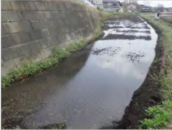
図 65 漏水事故の発生箇所
