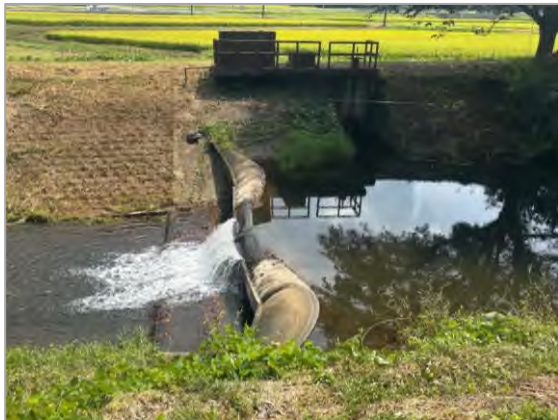
図 33 老朽化した農業水利施設
