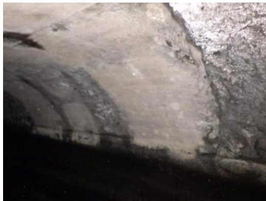
【劣化した水路トンネル】
