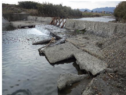
(破損したエプロンの様子)
