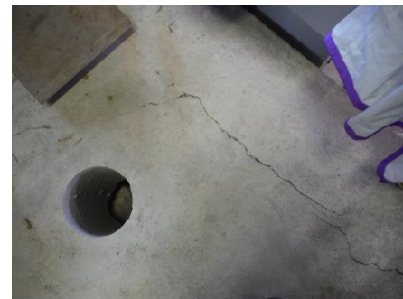
機場内のひび割れ
