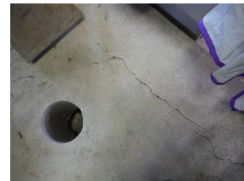
機場内のひび割れ
