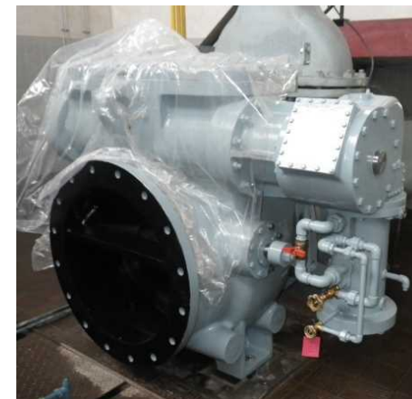
（ 更新された逆止弁 ）
