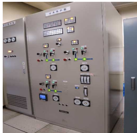
（ 更新された操作盤 ）
