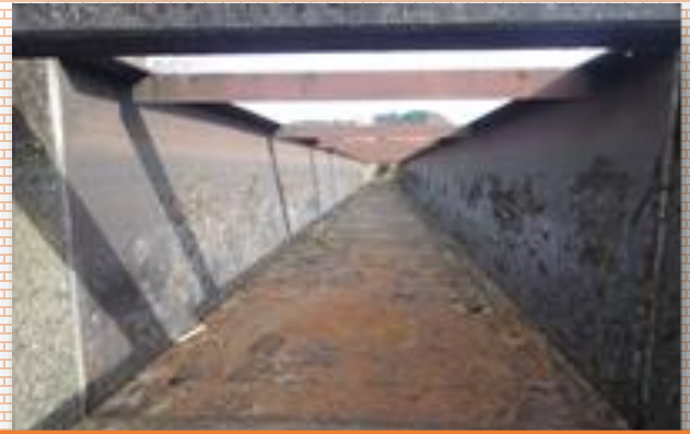
老朽化したサビだらけの水路橋
