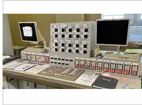
中央監視装置（更新対象）
