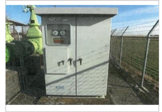
分土工制御盤（更新対象）
