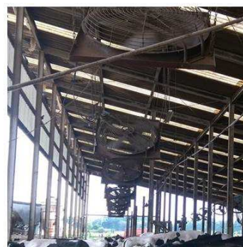
図 2 A 農場における送風機設置状況
