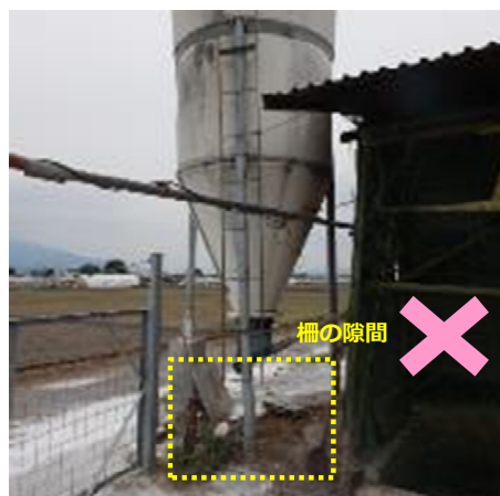
柵の設置がない箇所(隙間)あり
