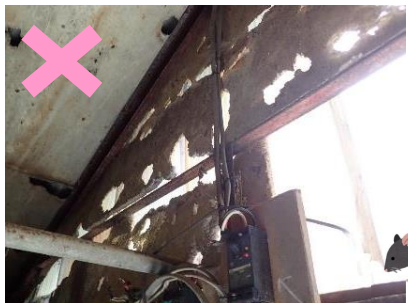
豚舎壁面の破損部
