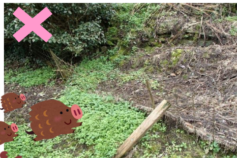
防護柵が低い部分あり
