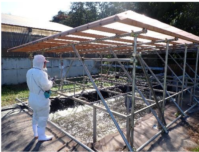
写真1 設置された脱臭槽
