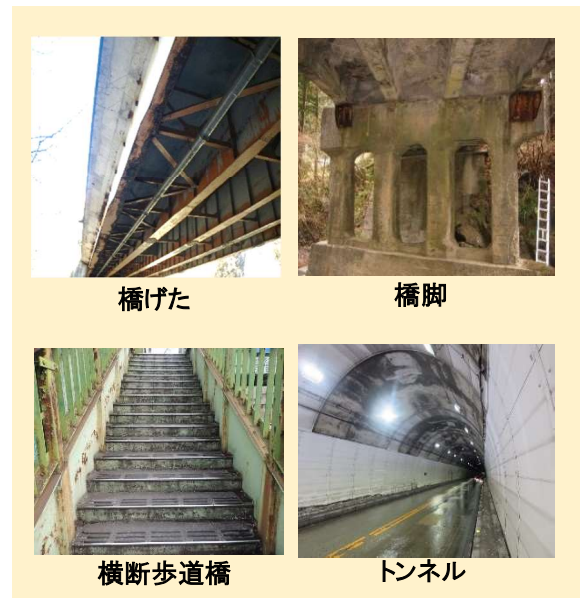
公共土木施設の老朽化状況
