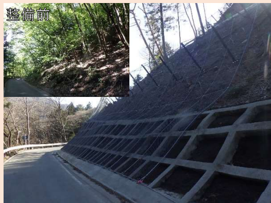
防災対策(県道塩原矢板線/那須塩原市)
