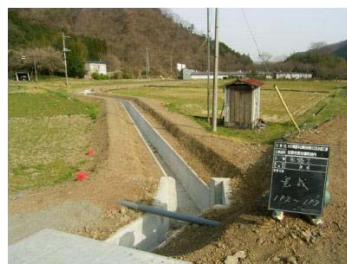
農業用排水施設（整備後）
