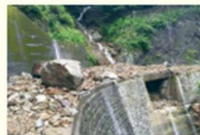
法面からの落石
