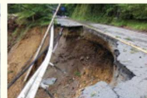
(国) 121号 藤原地区【被災状況】
