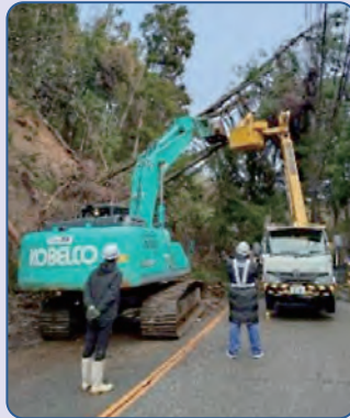
石川県穴水町 県道303号
