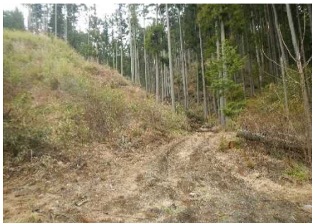
整備前の峠部交通不能区間
