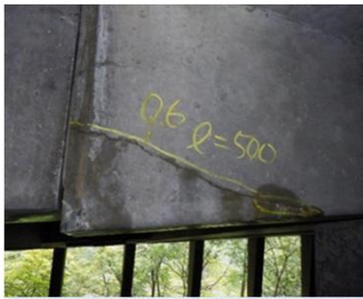
大田原土木事務所:板室洞門 横梁 ひび割れ(健全度Ⅲ)
