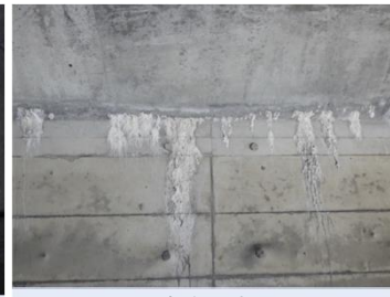
日光土木事務所:栃木平洞門 頂版 漏水(健全度Ⅱ)
