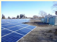
鹿沼市 太陽光発電所
