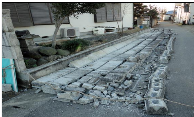
ブロック塀の倒壊
