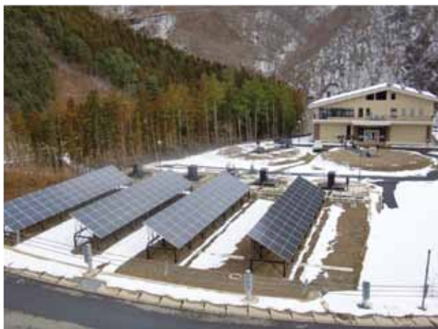
日光市 湯西川水処理センター
