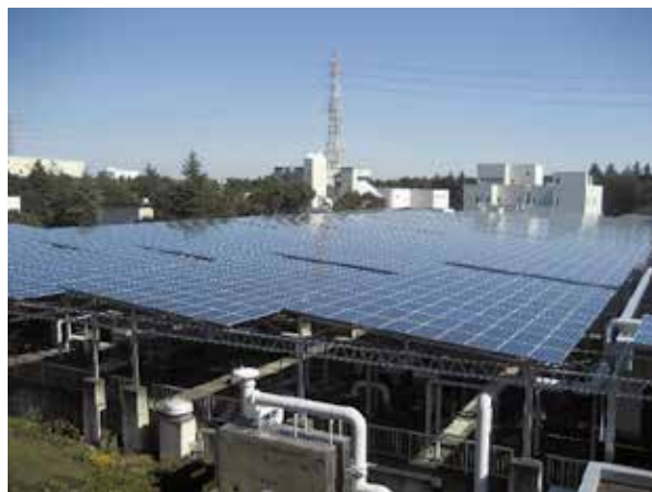
県央浄化センター
