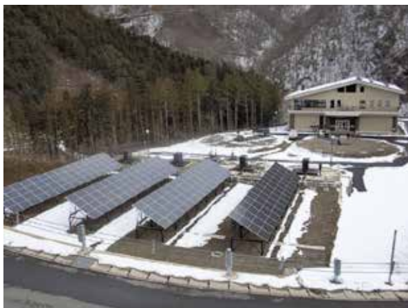
日光市湯西川水処理センター
