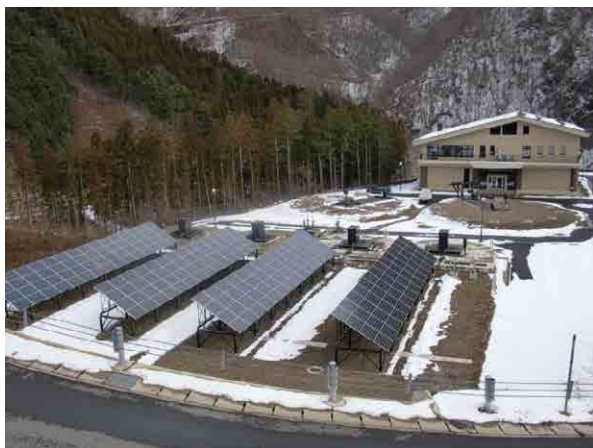
日光市湯西川水処理センター
