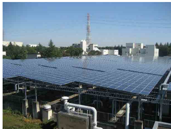
県央浄化センター
