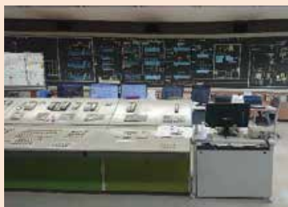
鬼怒川上流浄化センター監視制御設備更新後
