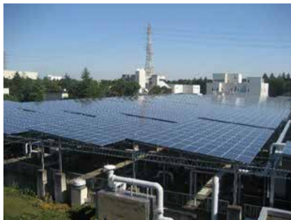
県央浄化センター
