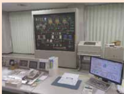
巴波川浄化センター監視制御設備更新後
