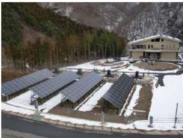
日光市湯西川水処理センター
