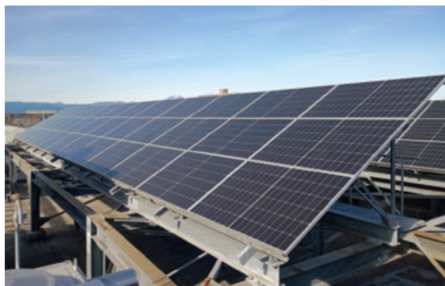
▲地球温暖化対策の一環として設置した太陽光発電設備 (太陽光発電設備：n型単結晶電池) 出力34.71kW)
