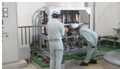
▲浄水場の機械点検
