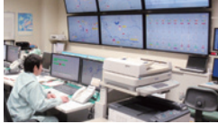
▲発電所・ダム の監視制御
